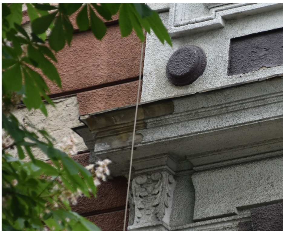
fot. 33: Naturalna odkrywka w obrębie gzymsu nadokiennego, elewacja wschodnia.
