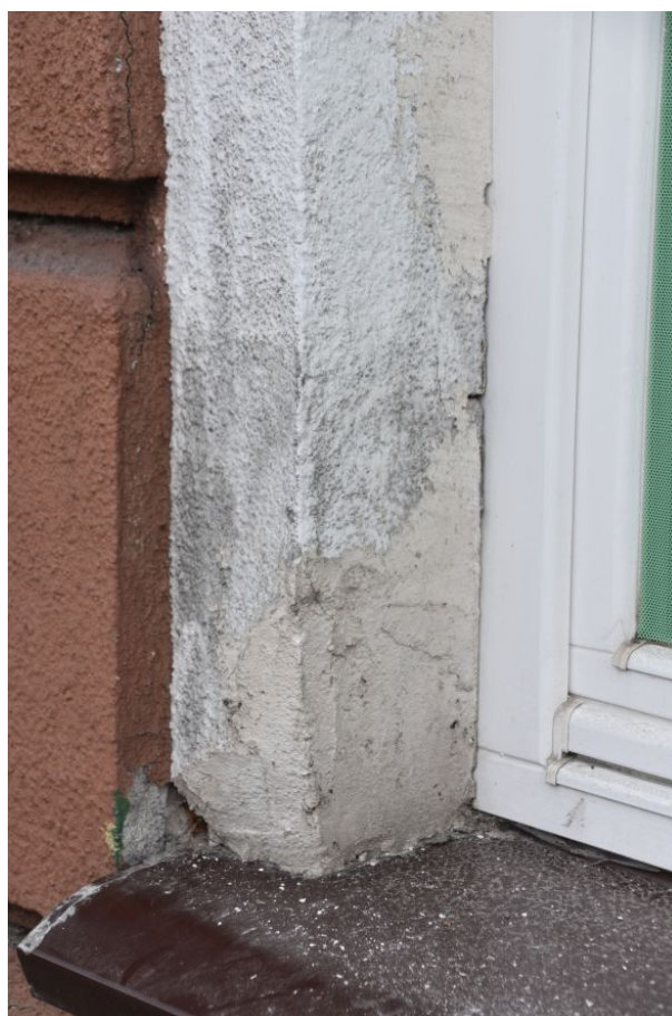
fot. 58: Ubytki w opaski okiennych były doraźnie, nieprofesjonalnie uzupełniane.
