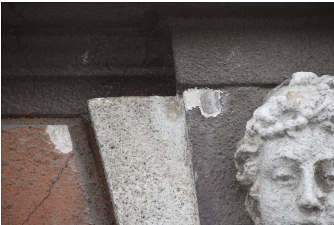
fot. 34: Odkrywki oznaczone nr 6, elewacja frontowa.
