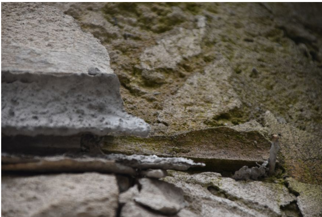
fot. 16: Naturalna odkrywka nr 33, elewacja południowa. Odsłonięte zostały poszczególne warstwy. Fragmenty oryginalnego profilowania boni.
