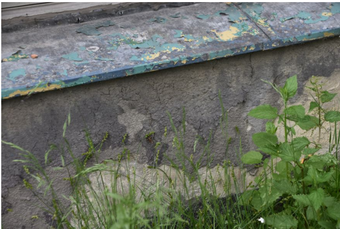
fot. 57: Ofasowanie jest znacznie zniszczone, warstwy starej farby łuszczą się i odpryskują.
