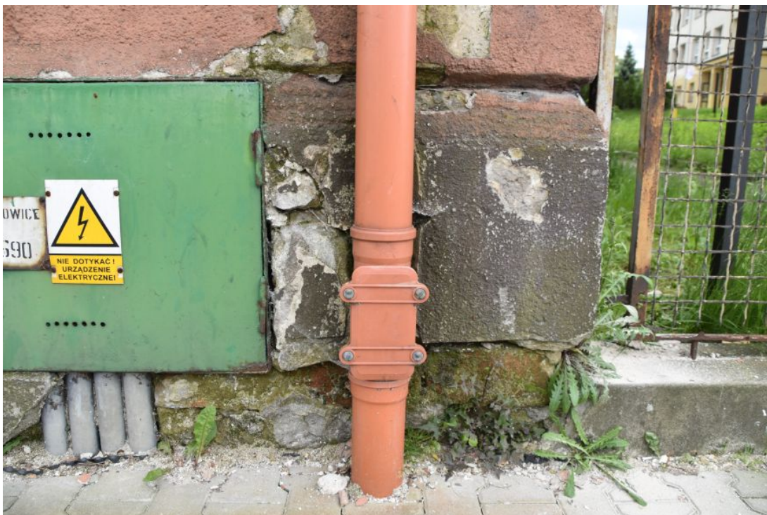
fot. 59: Stara skrzynka instalacyjna. Drzwiczki wymagają oczyszczenia i pomalowania na nowo, bądź wymiany. W pasie cokołu oraz w pobliżu rur spustowych elewacje są zagłonięte, w miejscach gdzie odpadł tynk spomiędzy cegieł wyrastają samosiejki.
