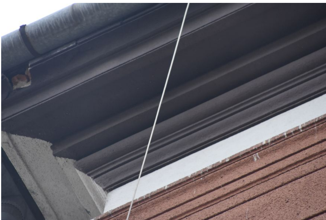
fot. 56: Gzyms wieńczący został pomalowany na dwa kolory. Na elewacji widoczne są zacieki farby.
