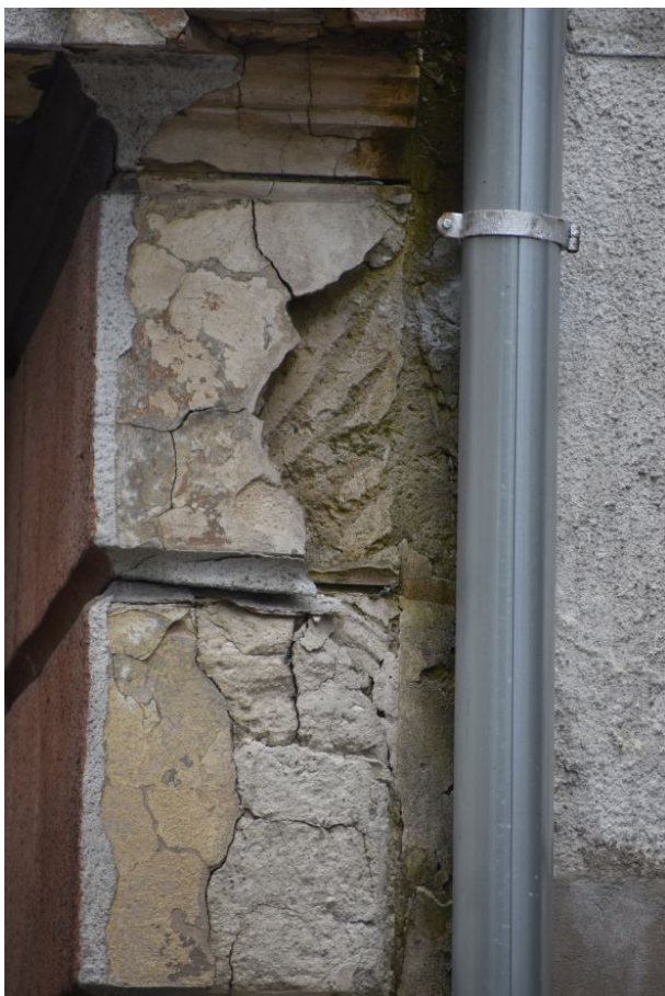
fot. 14: Naturalna odkrywka nr 33, elewacja południowa. Odsłonięte zostały poszczególne warstwy. Po prawej stronie widoczne nasieki wykonane w pierwotnej warstwie tynku. Widoczny gzyms wykonany został w tynku romańskim.
