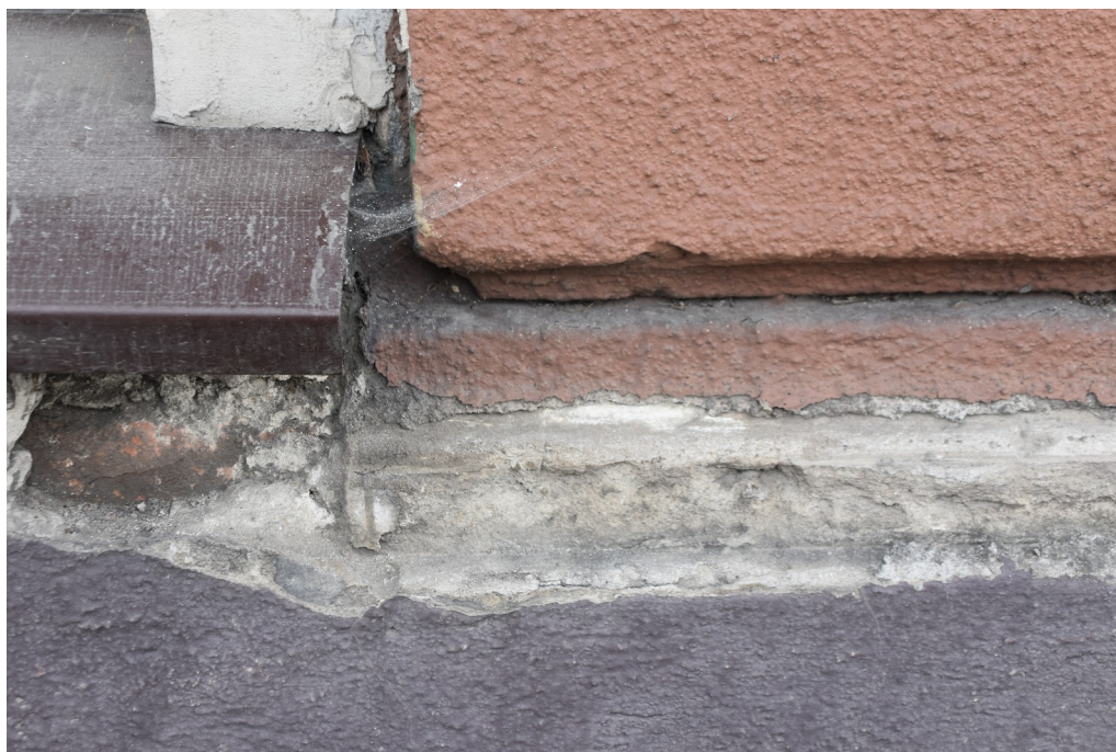
fot. 2: Odkrywka nr 1, elewacja frontowa. Poszerzona odkrywka naturalna ujawniła profilowanie cokołu skryte pod warstwą współczesnego tynku.
