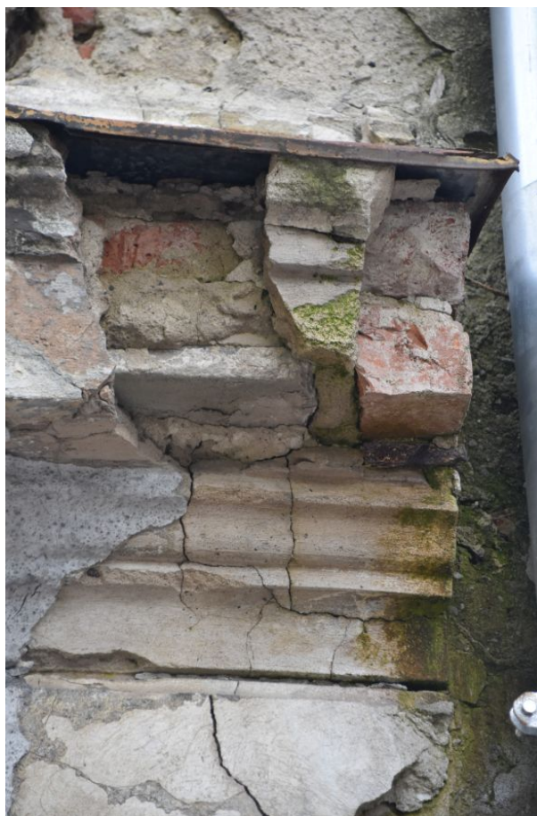
fot. 27: Naturalna odkrywka nr 33, elewacja tylna.
