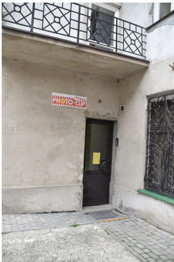
fot. 63: Dolna część elewacji tylnej została wtórnie otynkowana.
