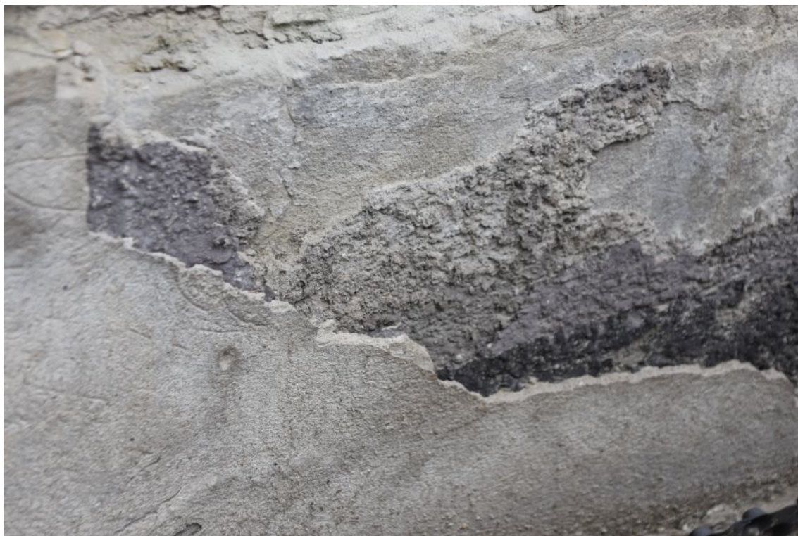
fot. 48: Odkrywka nr 32. Nawarstwienia w pasie cokołu elewacji tylnej. Widoczne współczesne tynki oraz zacierki cementowe.
