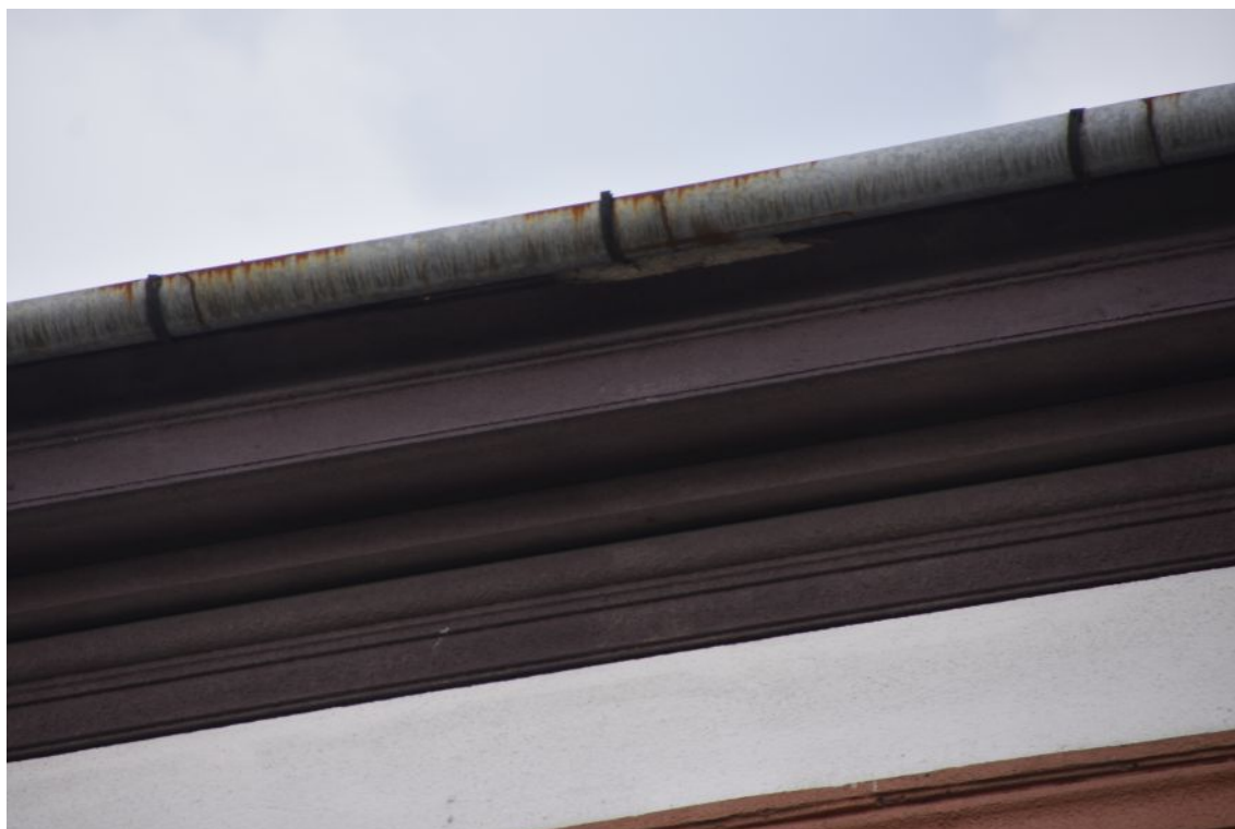
fot. 52: Rynny są skorodowane, wymagają wymiany.
