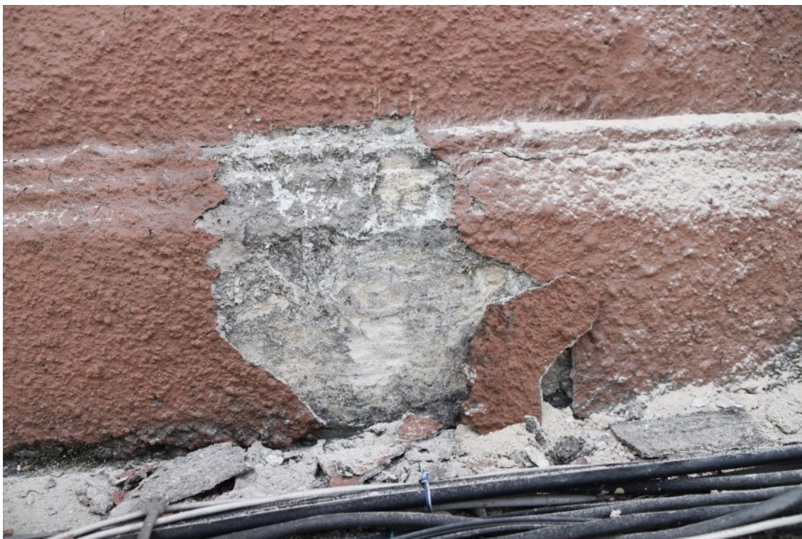
fot. 18: Naturalna odkrywka nad gzymsem kordonowym pomiędzy parterem, a pierwszym piętrzem.
