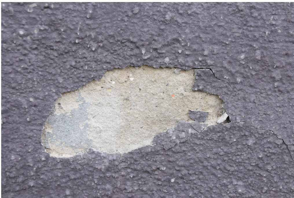
fot. 1: Naturalna odkrywka w pasie cokołu (odkrywka nr 2). Tynk pokryty jest cienką szlichtą w kolorze jasnoszarym. Na szlichtzie położony współczesny tynk typu baranek.
