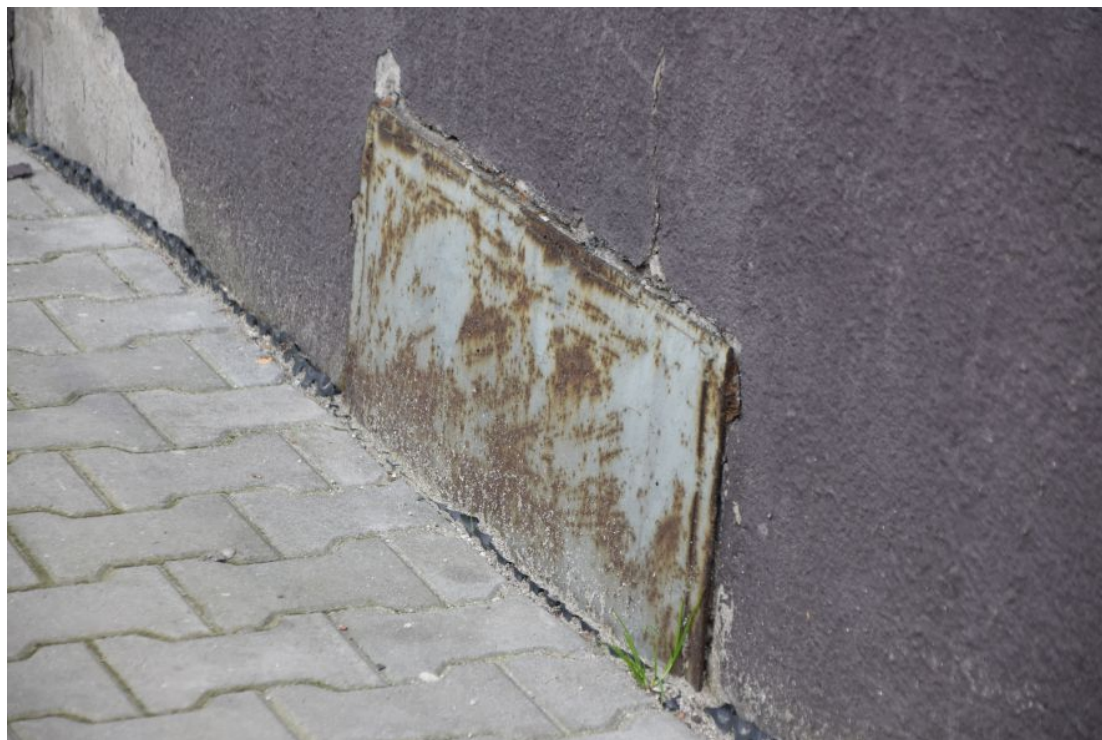
fot. 60: Kłapa w przyziemiu budynku, widoczna znaczna korozja, wymaga wymiany, bądź oczyszczenia i zabezpieczenia.
