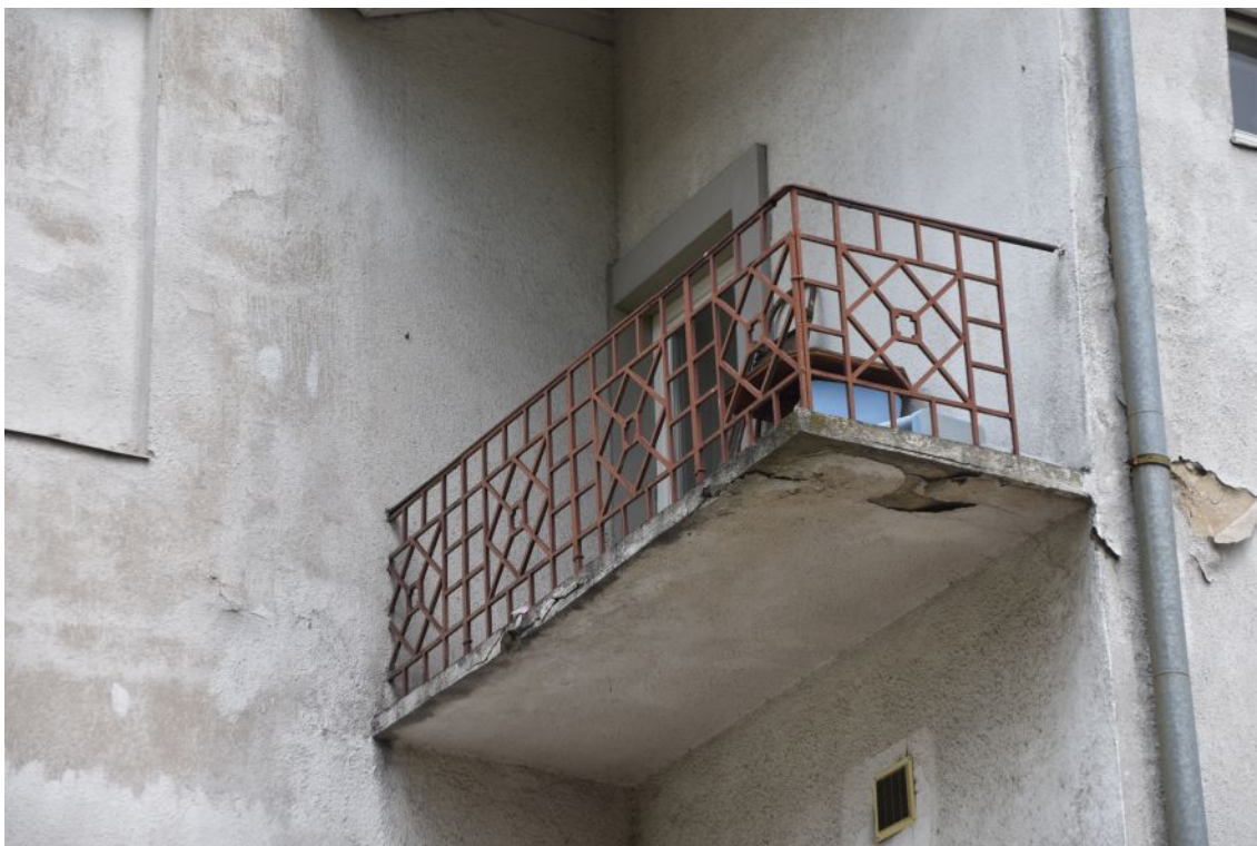
fot. 61: Jeden z balkonów elewacji tylnej. Płyta balkonowa rozwarstwia się, balustrada wymaga oczyszczenia i zabezpieczenia przed korozją. Wokół otworu drzwiowego wykonano prostą opaskę, niepasującą stylistycznie budynku.
